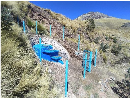
Protección de sistema de agua potable, comunidad de Huillcuyo, PMS Omacha
